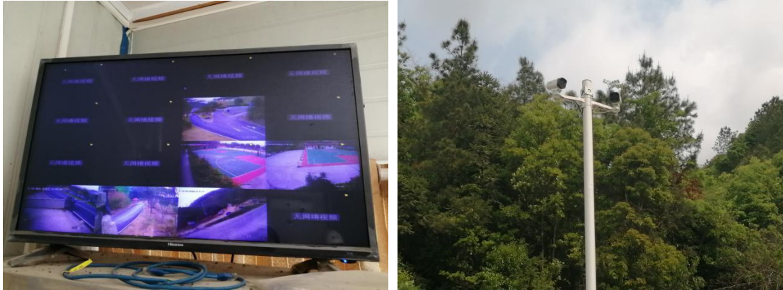
照 5-9 矿山视屏监控系统不完善
